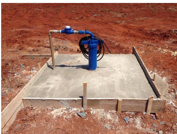
Cabeça do poço e Medidor de vazão
